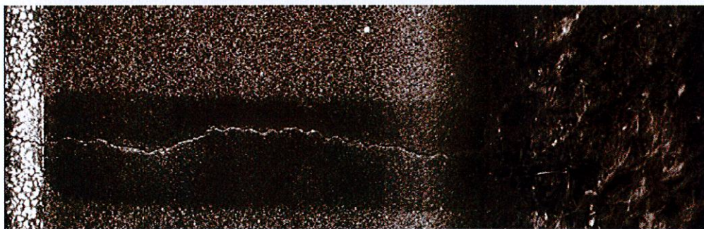
Rysunek 2.10 Obraz zarejestrowanego uszkodzenia na powierzchni nawierzchni
